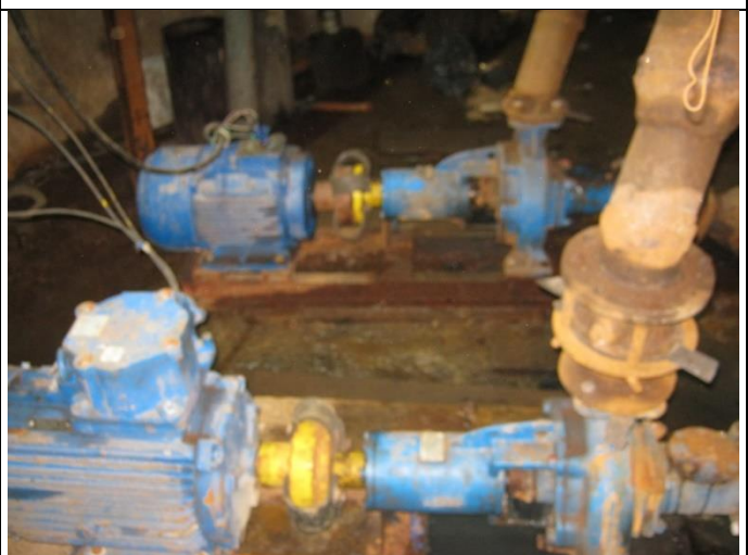
Рисунок 9.2.6 – Насосы в КНС ул. Ленина (станция перекачки 2 агрохимия)
