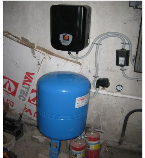
Узел управления скважиной
