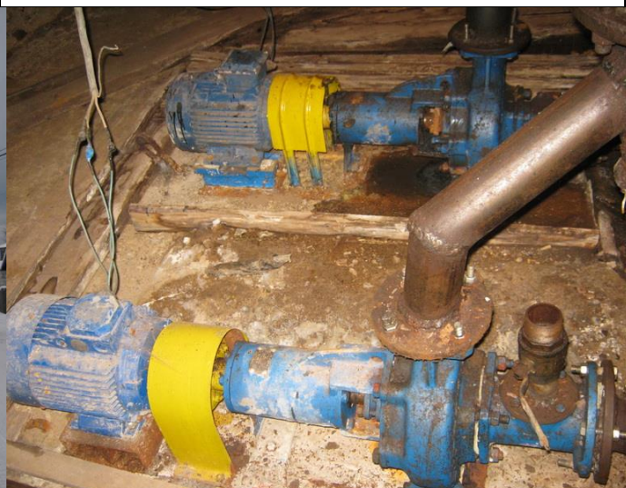
Рисунок 9.2.4 – Насосы в КНС ул. Ленина (станция перекачки 1 агрохимия)
